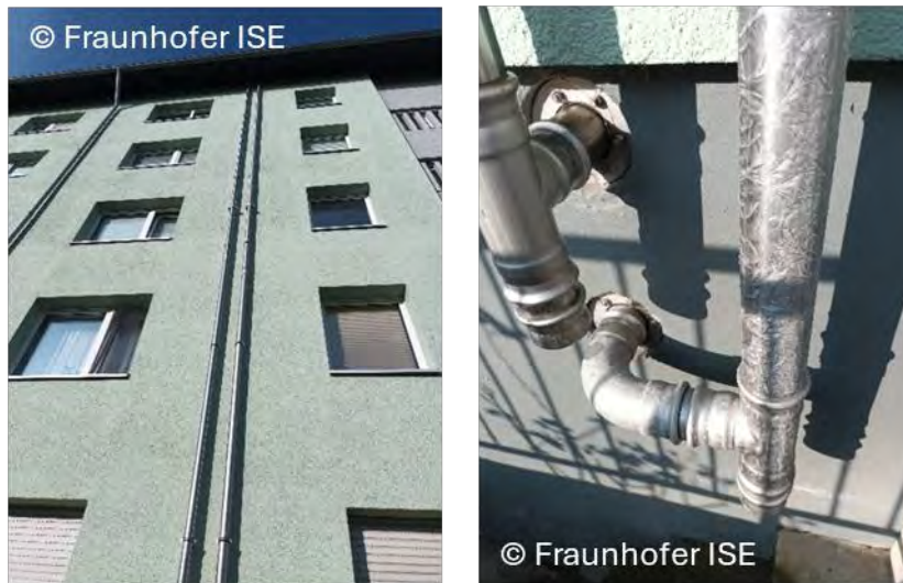
Abbildung 102: links: Beispiel für eine an der Fassade montierte Versorgungsleitung; rechts: Eisbildung an der Leitung (fleckige Oberfläche am rechten Rohr) und am Wandkanal
